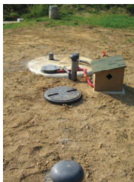
CSTB : Coffret électrique installé dans la cabane
